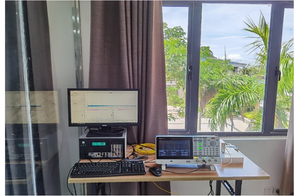
图 3 机房内搭建的试验环境
